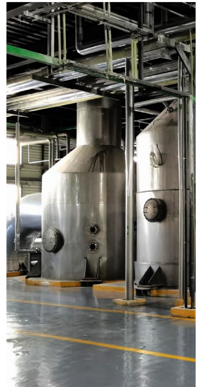
西部产业基地污水处理设施
