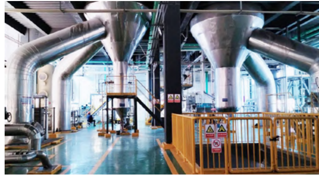
中部产业基地 硫酸钠 MVR 蒸发器保障蒸汽再利用
