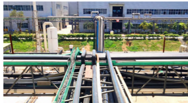
西部产业基地 车间增改超越管道节约电能提高功效
