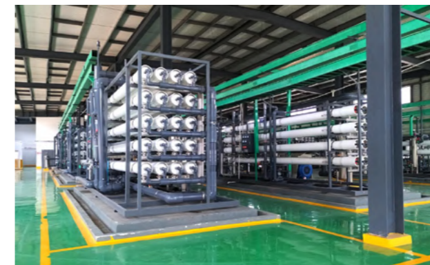
中部产业基地反渗透 - 纯水生产车间
